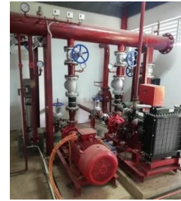
Gambar 6. Instalasi perpipaan pompa
