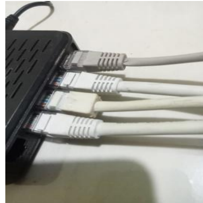
Gambar 6 Pemasangan kabel LAN dari modem ke Hub dan dari Hub ke PC
