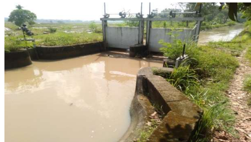
Gambar 3. Bangunan Sadap Saluran KR 2A Kiri Desa Purwodadi Kecamatan Trimurjo Kabupaten Lampung Tengah (Sumber: Riedo Riswan Pratama, 2023)
